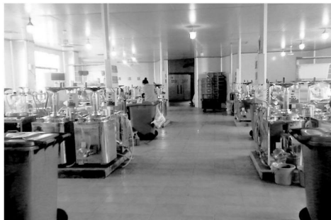
河南中医学院第一附属医院 安装90台密闭两煎煎药机
